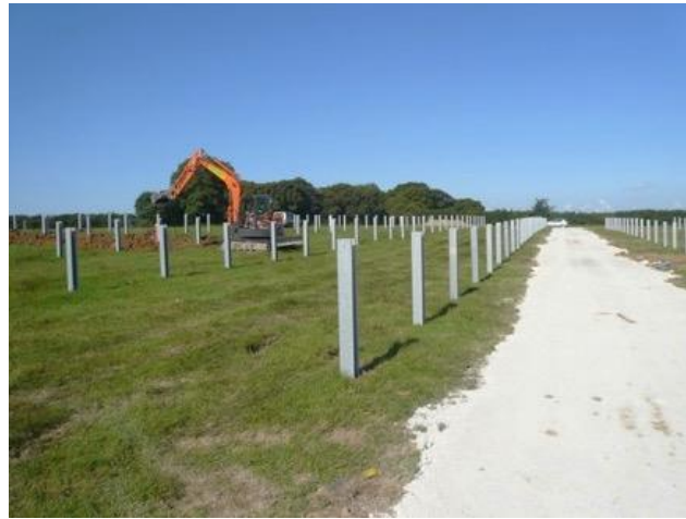
Exemple de piste en matériaux concassés (source : KRONOS SOLAR)
