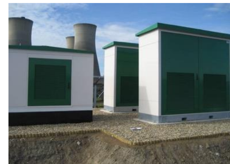
Exemple d'un poste de transformation (source : KRONOS SOLAR)
